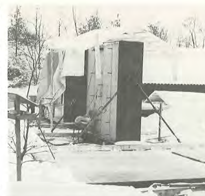
Væggene umiddelbart efter afformning, hvor afkølingen af betonoverfladen er årsag til temperaturbelastningen over tværsnittet. I afkølingsperioden kunne fremkomst og udvikling af revner iagttages. Bemærkelsesværdigt var især, at de konstaterede revner ikke kunne ses på overfladen, når der var opnået temperaturligevægt i tværsnittet.
