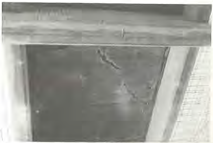
Reparation af betonribbedæk. Efter første støbning konstateredes tydelige revner i den nystøbte betonplade. Her er pladen set nedefra.
